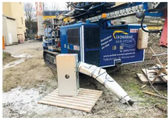
Bohrgerät mit aufgebautem Thermal-Response-Test
