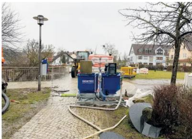
Die moderne Injektionsanlage der Firma Dippold
